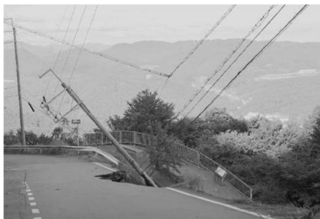
7/7 セタ豪雨による道路崩落
