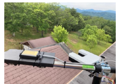
図 8 新たに設置された雨センサーの様子
