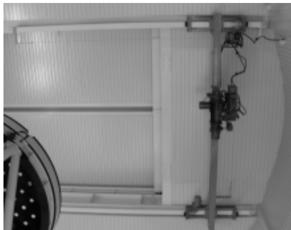
写真2: 同じ観測室の1トン天井クレーン
