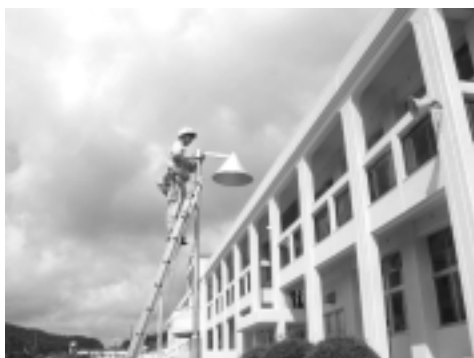
無光害タイプの外灯が設置されました
