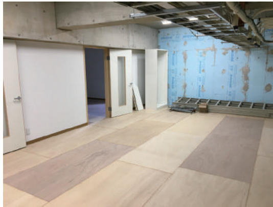
「完成」した南館中3階の部屋。壁紙や床材は自分たちで設置します！
