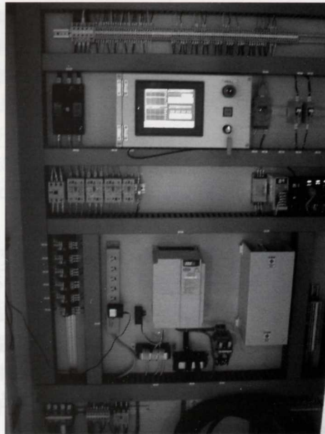
Fig. 8. 観測室壁面に設置された主制御盤
