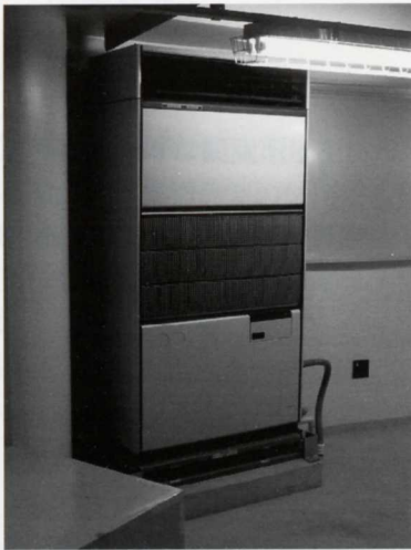
Fig. 12. 観測室に設置された除湿器。メンテナンス室にも同型の除湿器が設置されている
